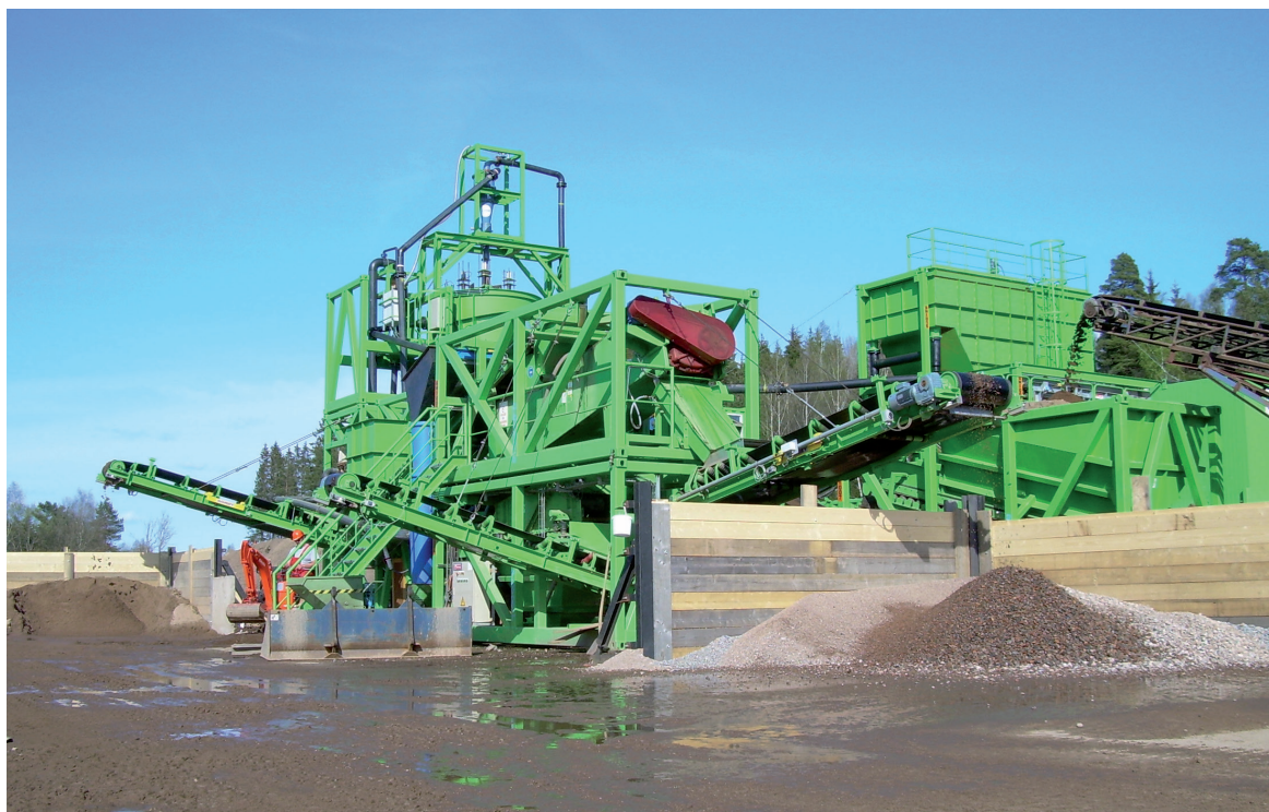
Een voorbeeld van een grondreinigingsinstallatie. Schiphol heeft een vergunning aangevraagd om een dergelijke installatie op Schiphol te plaatsen voor het reinigen van PFAS-houdende grond.
